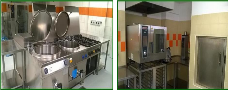
Obr. 5 Obnovené kuchynské zariadenie (Zdroj ULZ OS SR)
